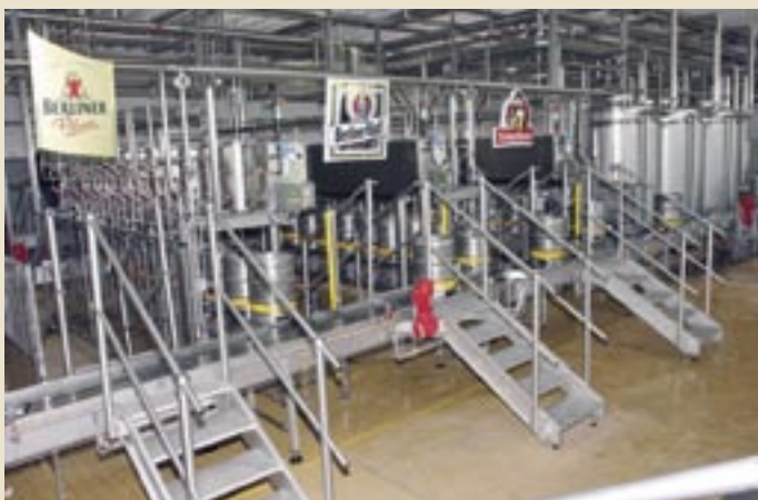
Abb. 4 Komplettanlage mit vier Reinigungs- und Fülllinien
