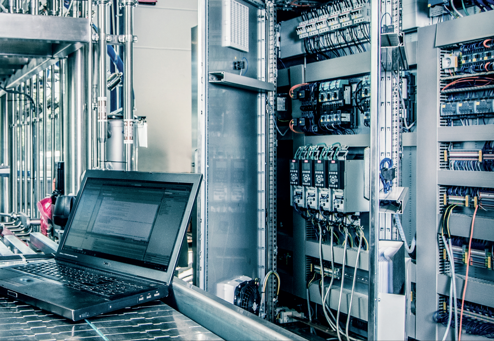
Mittels moderner Steuerungstechnik und einer durchgängigen Automatisierung können Wasser- und Energieverbräuche einer Keg-Anlage gesenkt werden.
